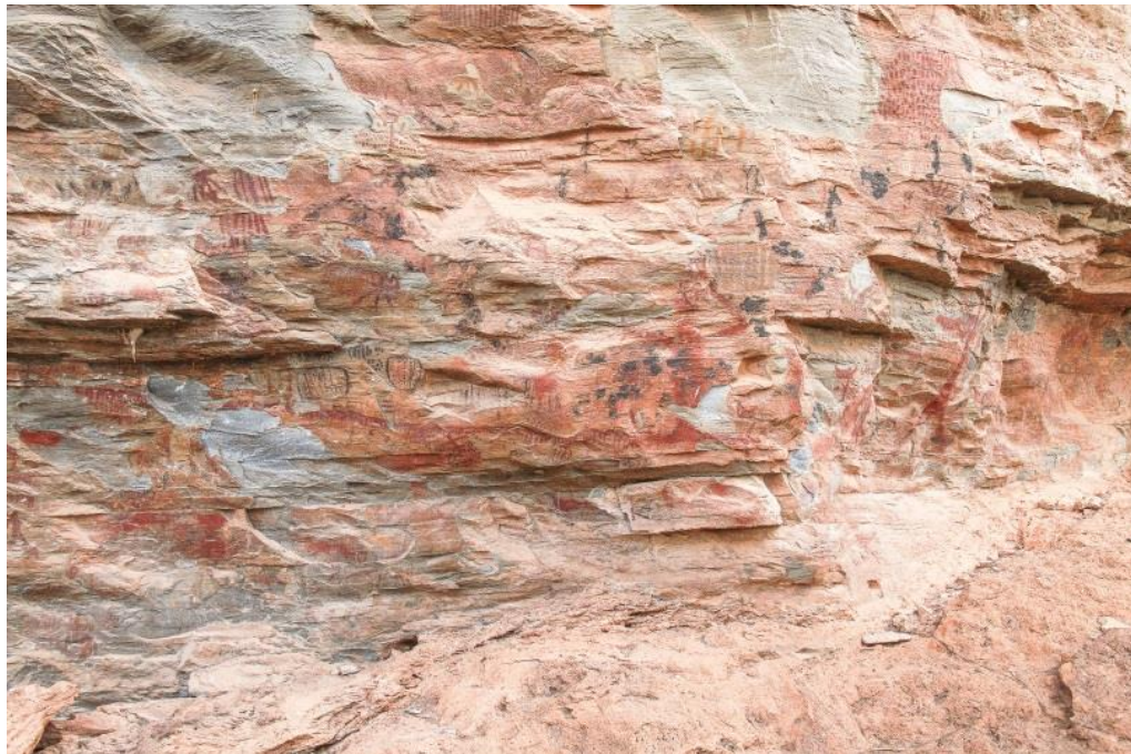
Figura 117 – locais de ocorrência de descamação do suporte pétreo por termoclastia
